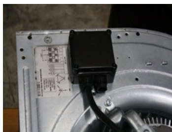
Caja y cableado estanco IP 54
